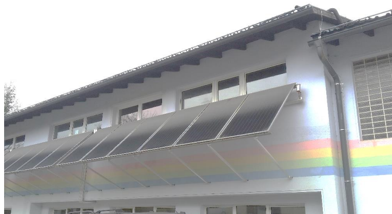
Termični solarni sistem na zunanjem bazenu v mestu Liezen (Avstrija)
