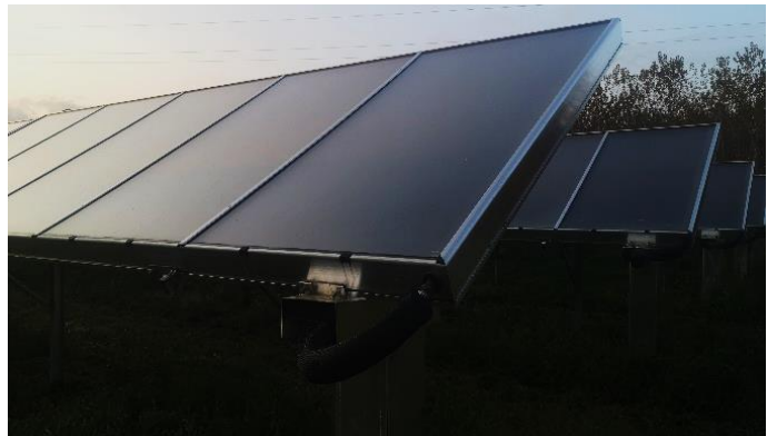
Ηλιακοί συλλέκτες τοποθετημένοι στο έδαφος στο St. Ruprecht an der Raab (Αυστρία)
